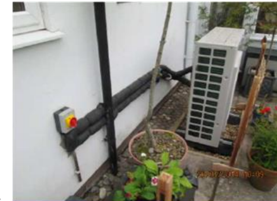
Bombas de Calor
